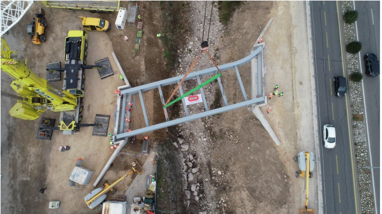
Figure 3 : Pose de la charpente métallique de la passerelle Carrefour - marché M2 (entreprises BOUYGUES TPRF et COLAS) – crédit photo SMA
