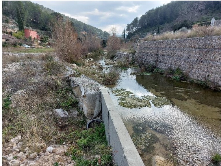
Illustration du désordre à traiter sur l'ouvrage de Rebouillon.
