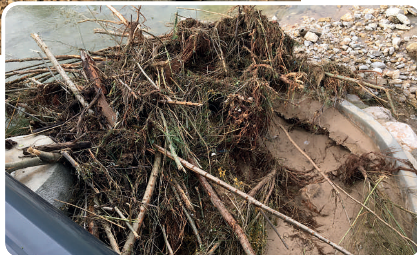
Commune de Taradeau Embâcles sur le pont de la RD10
